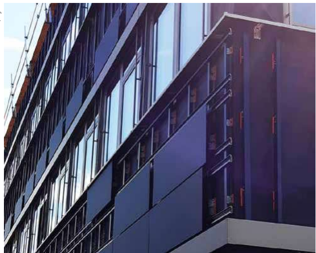
Hier wird eine Fassadenanlage mit der Unterkonstruktion Crossfix von Ejot und Modulen von Avancis bestückt.
