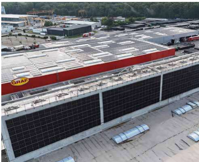
Fassadenanlage mit 171 Kilowatt Leistung am Tengerer Produktionssilo von Otto Graf.
